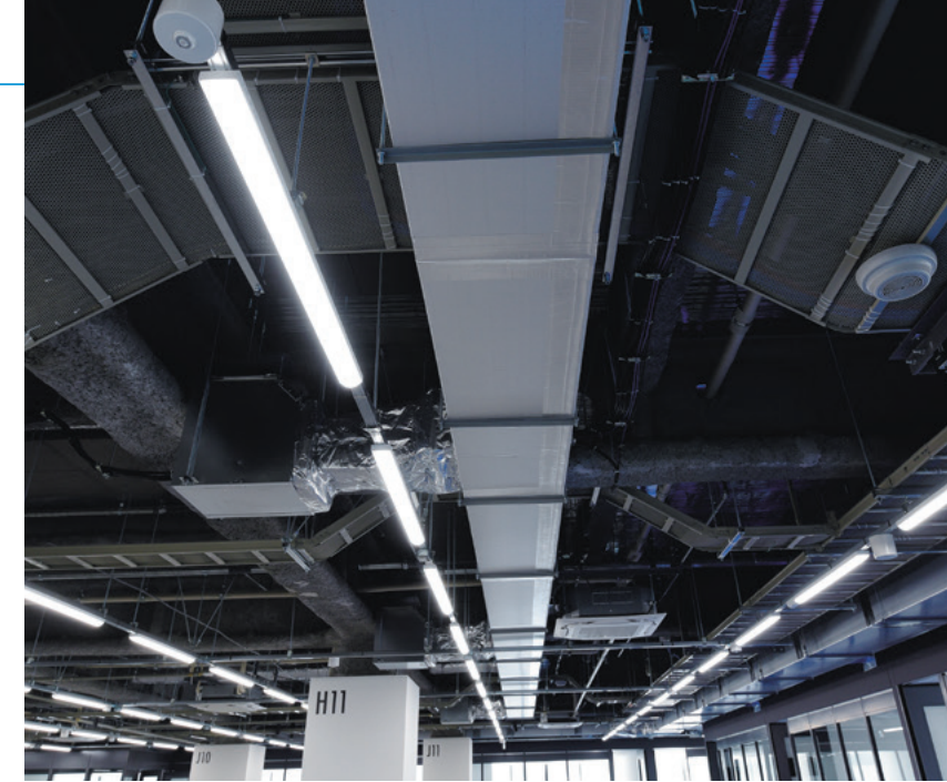
中の配線や配管がむき出しの天井
