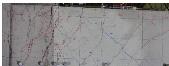
写真-1 最大耐力時の基礎梁のひび割れ状況（試験体DR-2）
