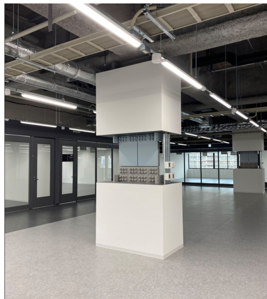
オープンラボ部の粘弾性体ダンパー外観
