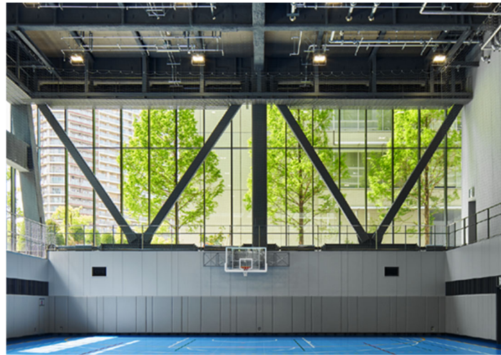
体育館部のオイルダンパー外観
