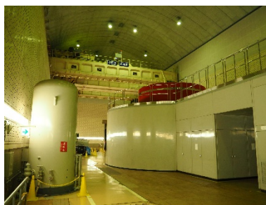
(写真 2.2) 発電機 (1 号機)
