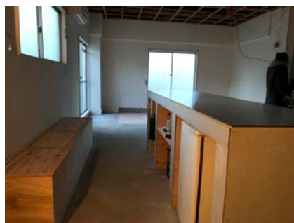
pic9.水道管の目隠しベンチ
